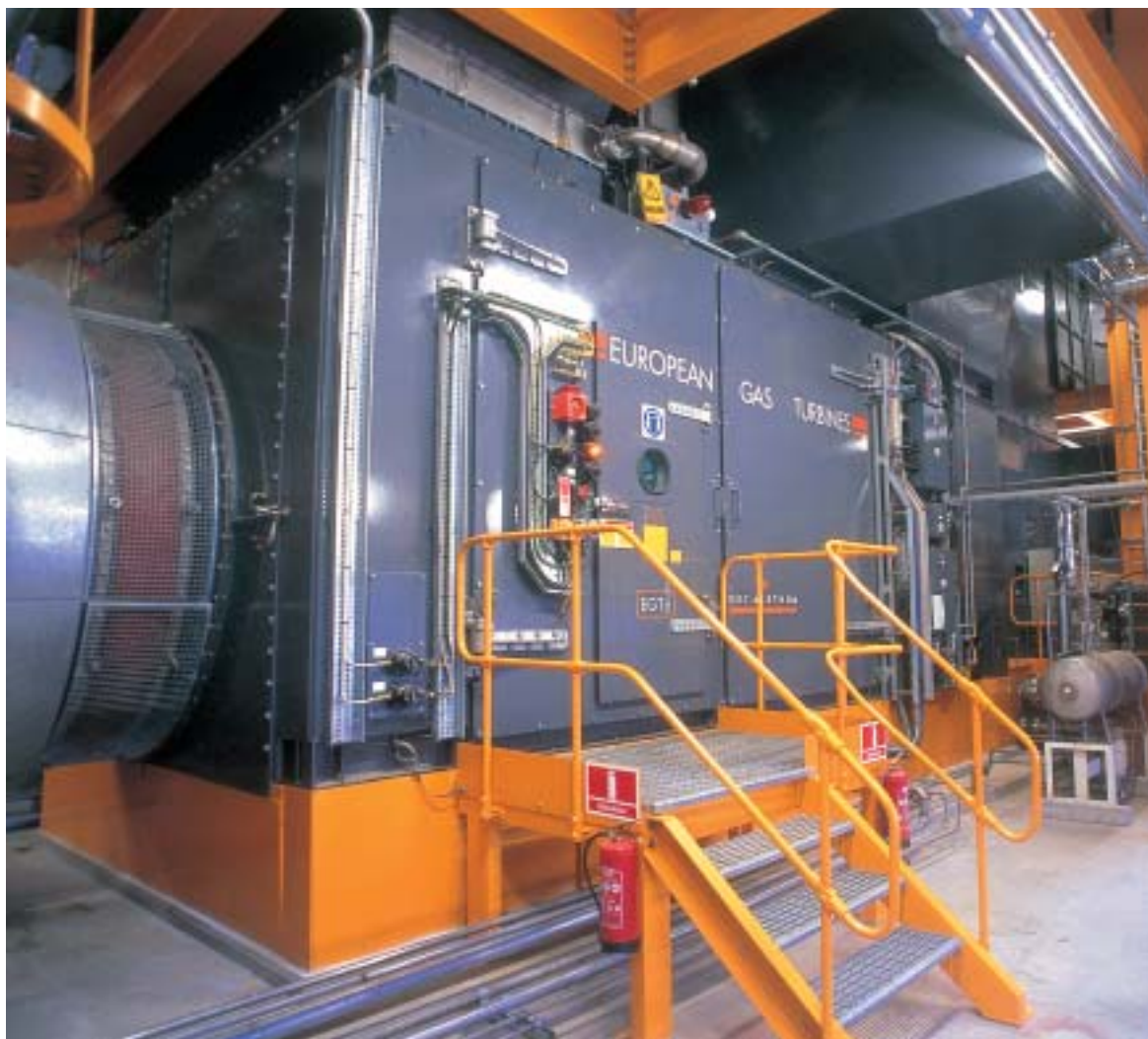
Gasturbine på Sønderborg Kraftvarmeværk.
