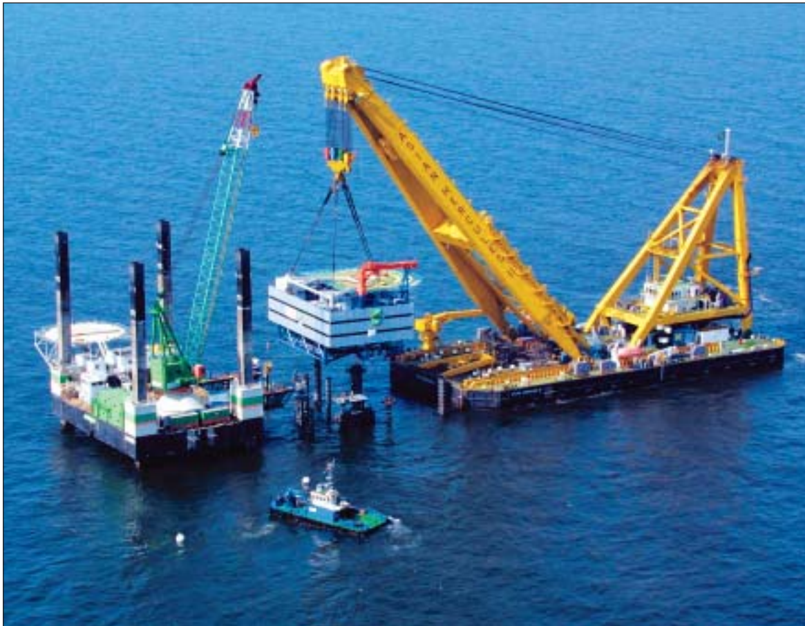
Flydekranen "Asian Hercules" satte tirsdag den 16. april Eltra's 1.200 ton tunge transformerplatform på plads til havmølleparken på Horns Rev.
