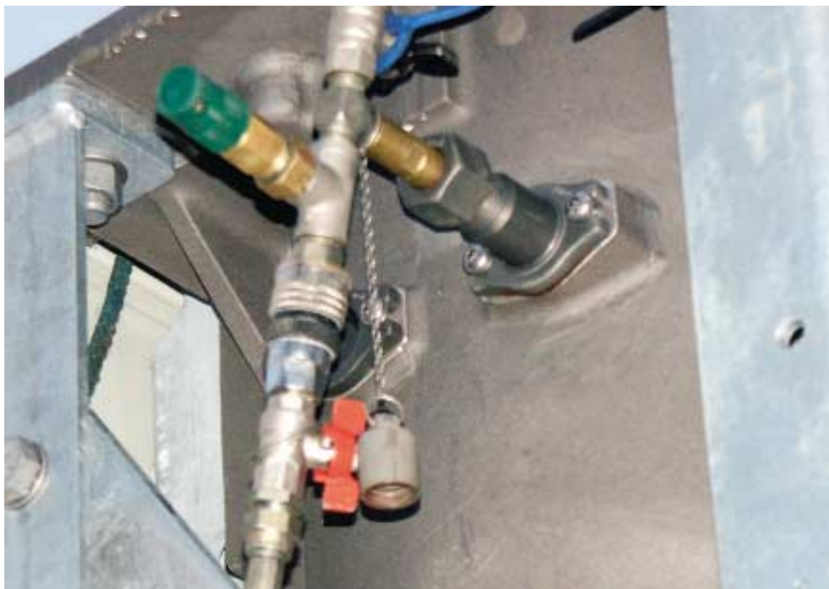
Ventilsystem til minimering af SF 6 -gasudslip under påfyldning.
