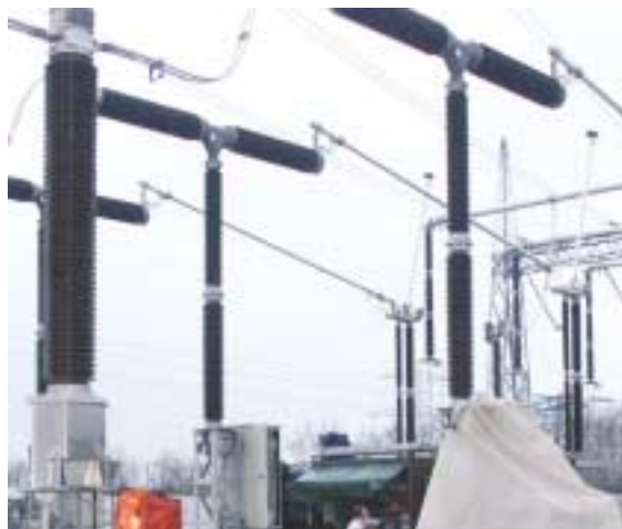
400 kV-afbrydere, station Trige, ved påfyldning af SF 6 -gas.
