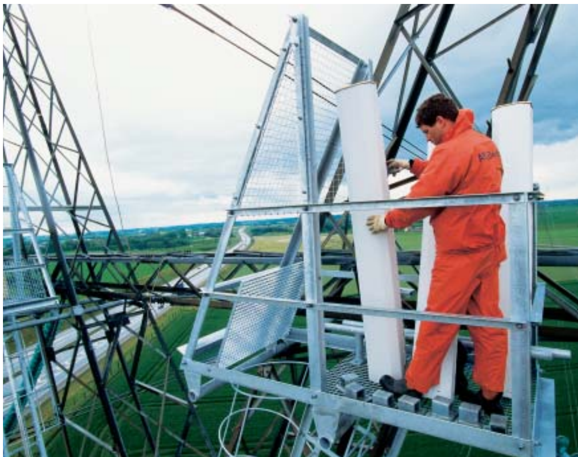
Højden og placeringen gør ofte højspændingsmaster ideelle til mobilantennener. Her er en tekniker ved at montere antenner i en af Eltra's 400 kV-master.
