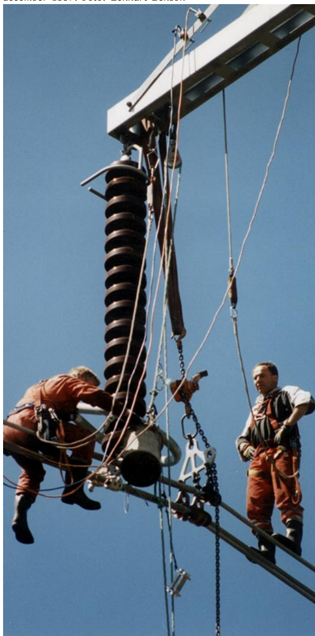
Linor hängs upp i den nya Västkostledningen, som blev driftklar i december 1997. Foto: Lennart Benson
