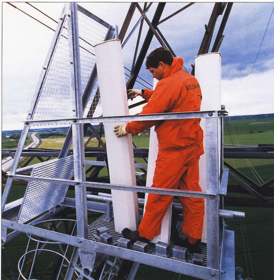
Nye antenner i mobiltelefonsystemet placeres ofte på højspændingsmasterne.
